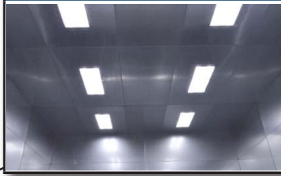
Système d'éclairage à DEL
